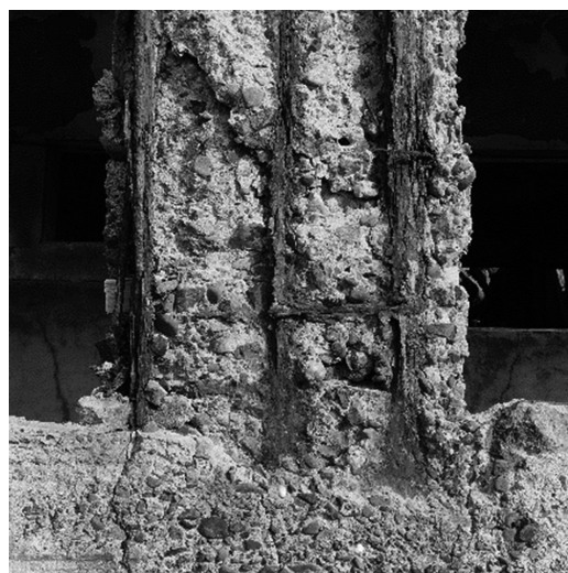
図4 鉄筋の腐食により劣化したコンクリート柱。コンクリートが剥がれ腐食した鉄筋がむき出しになっている(2016年長崎県端島(通称、軍艦島)にて撮影)。
