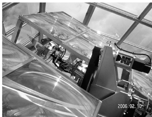
図3 太陽光熱複合システム実証装置.
